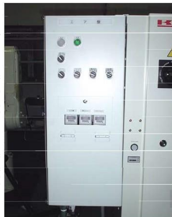
Unité de contrôle pour l'unité de peinture
